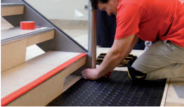
Markierung in einfacher Ausführung mit Klebeband sowie Noppenplatten vor einer stark frequentierten Treppe.
